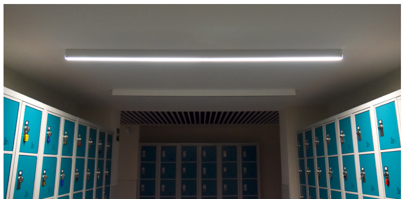
ILUMINACIÓN EN SUPERFICIE ILUMINAÇÃO EM SUPERFÍCIE
